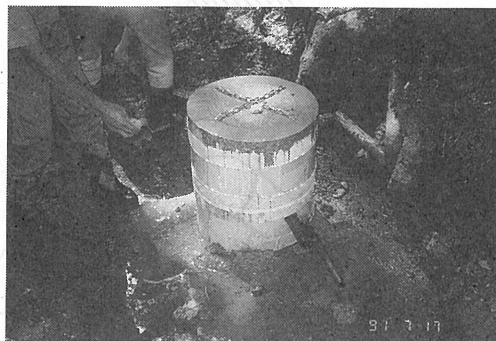
Photo. 5 完成した貯湯槽
